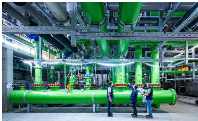
Energiezentrale BMW Straßkirchen
